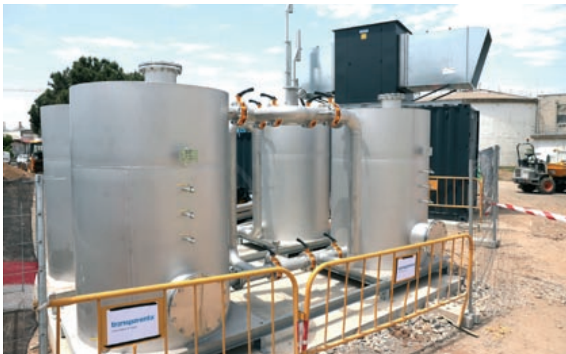
Els filtres de carboni de la planta i, darrere, els filtres de membranes que fan el procés d'enriquiment del biogàs
