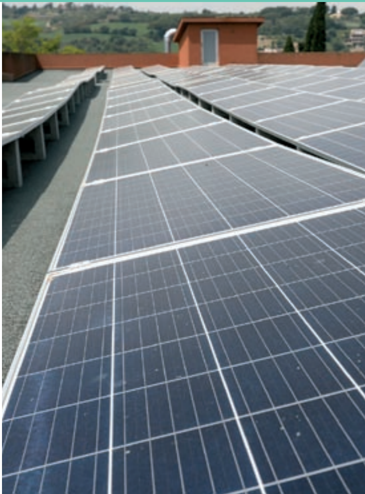
Plaques solars a la coberta de l'Escola Municipal de Treball de Granollers
