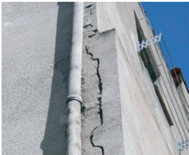
Mur del carrer Nobles Gironella del qual alerten el perill de despreniment
