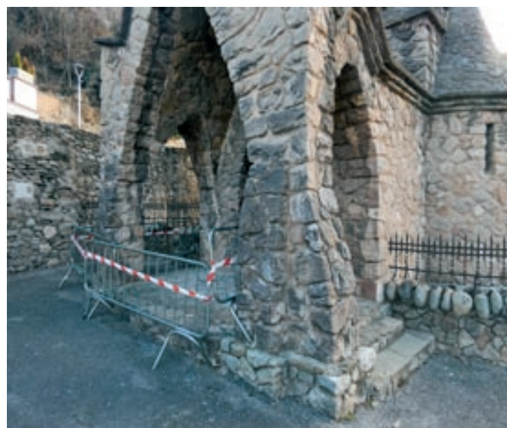
L'entrada de la capella està precintada
