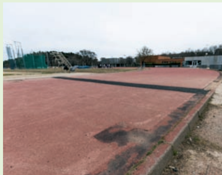
Detall del mal estat actual de la pista d'atletisme de Vic
