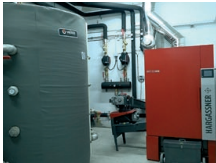
La caldera de biomassa que s'ha ubicat a la nau de la brigada
