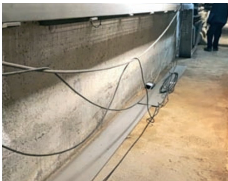
La instal·lació malmesa de la depuradora del CBT situada a Montornès
