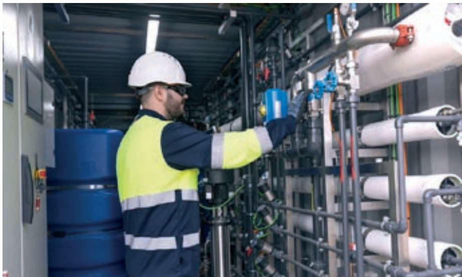
Tècnic treballant a la Plataforma Experimental de Reutilització d'Aigua a l'EDAR de Mataró
