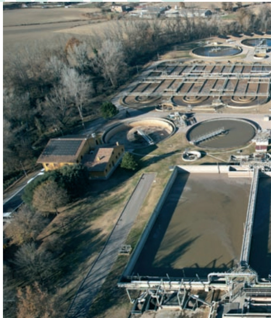
Depuradora d'aigües residuals de Vic (EDAR Vic), on es tracten les aigües de Gurb, Santa Eugènia
