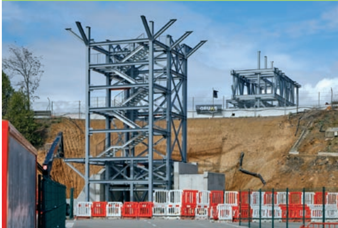
La nova passera del Circuit, encara en construcció, quedarà instal·lada a la contrarrecta, entre els revolts 9 i 10
