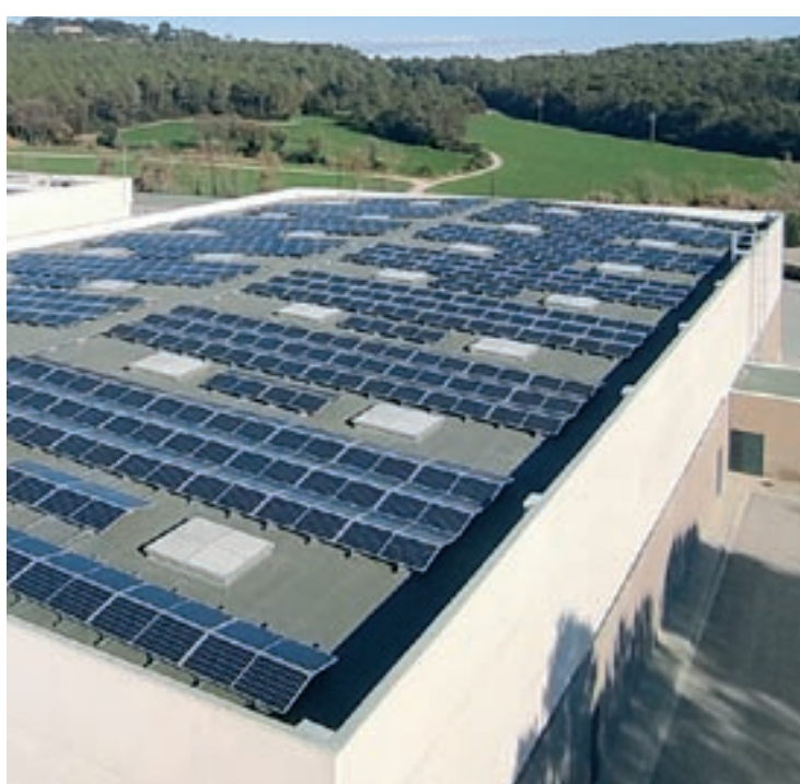
Una instal·lació de SolarProfit per a l'empresa gironina Escobedo
