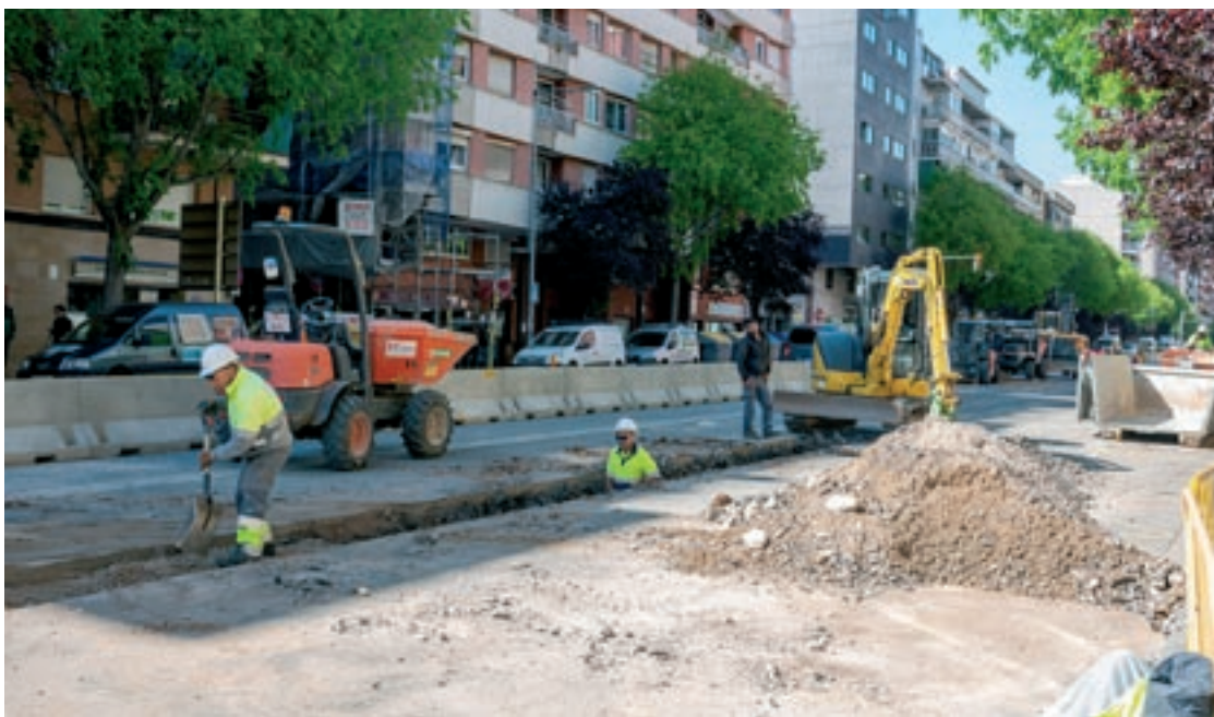
Els treballs han començat amb la construcció d'una nova canonada per la xarxa d'aigua potable a la calçada
