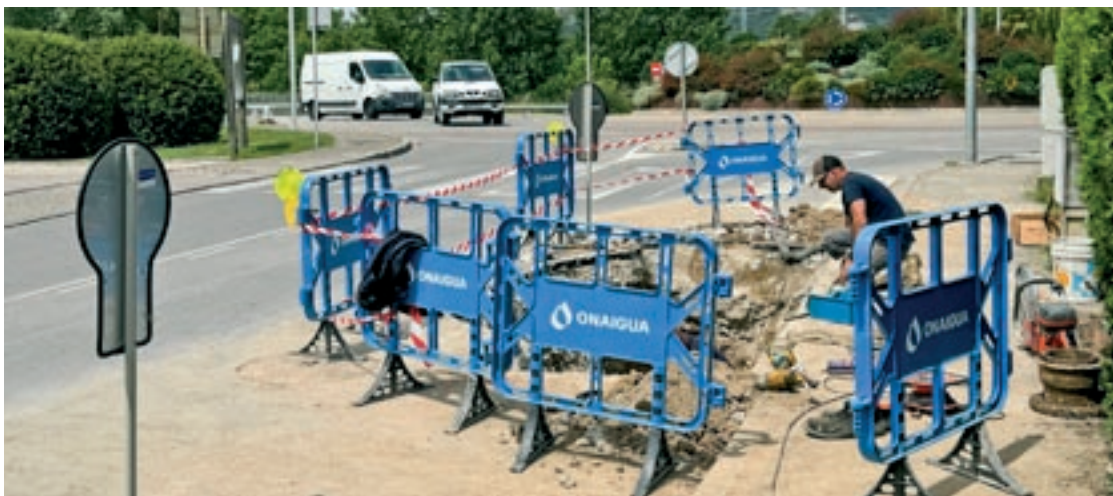
Operaris instal·lant una vàlvula per sectoritzar el carrer del Ter i el polígon Matabosch, aquest dimecres
