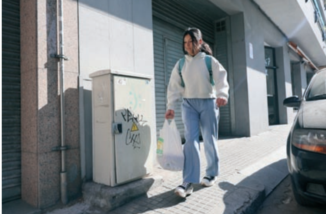
Una persona passa per davant de l'armari elèctric situat en una façana entre dos guals al carrer Via Ronda
