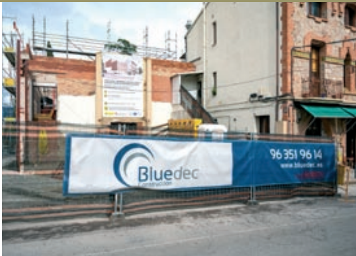
L'estat de les obres de la Sala municipal quan es van aturar a finals d'abril
