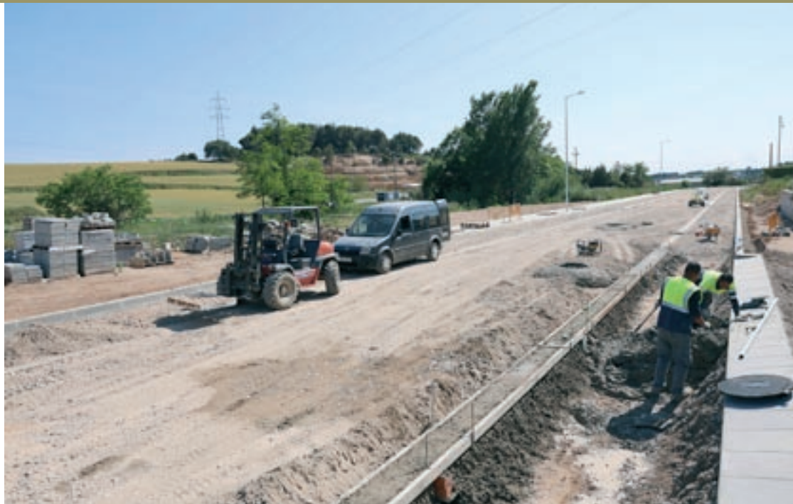
Les obres d'urbanització del sector N, a la carretera de Cardedeu, aquesta setmana
