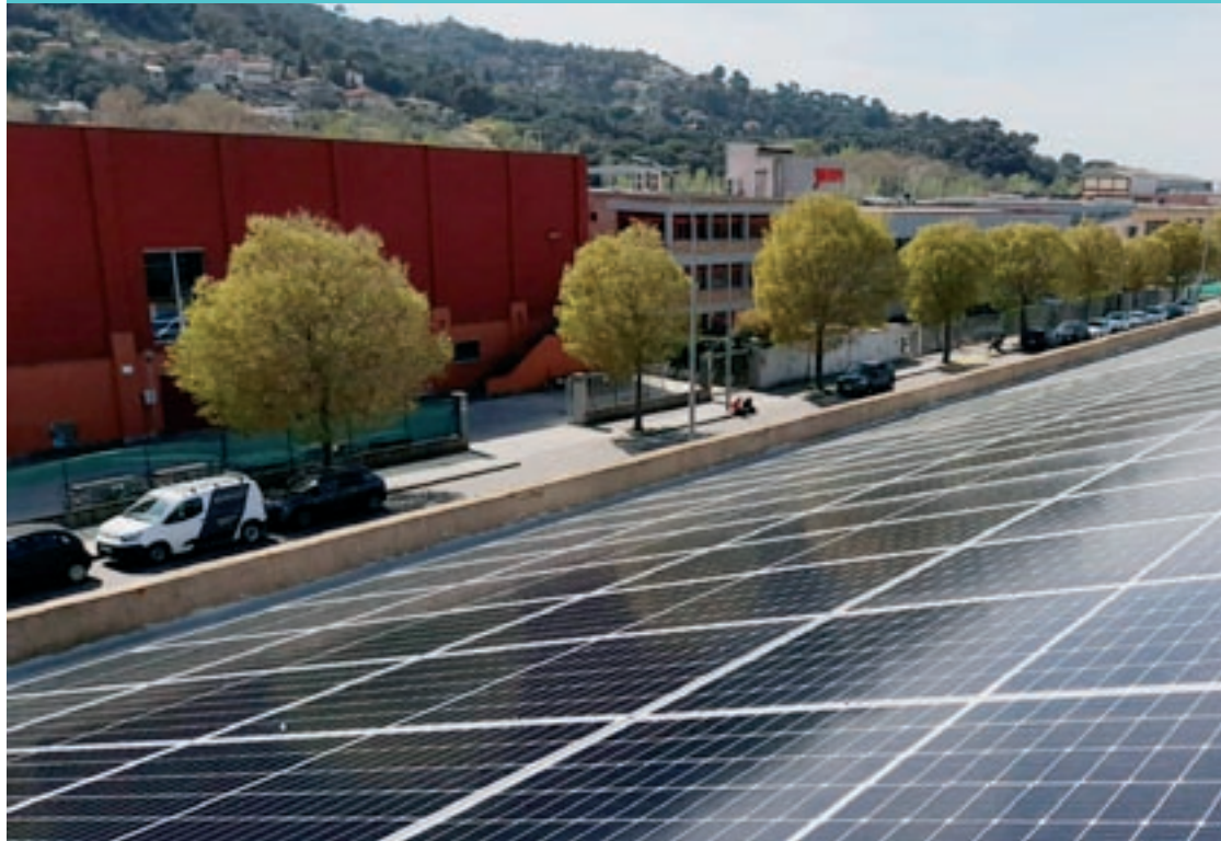
Una instal·lació solar industrial de la firma de Llinars per a una empresa que opera des de Montornès
