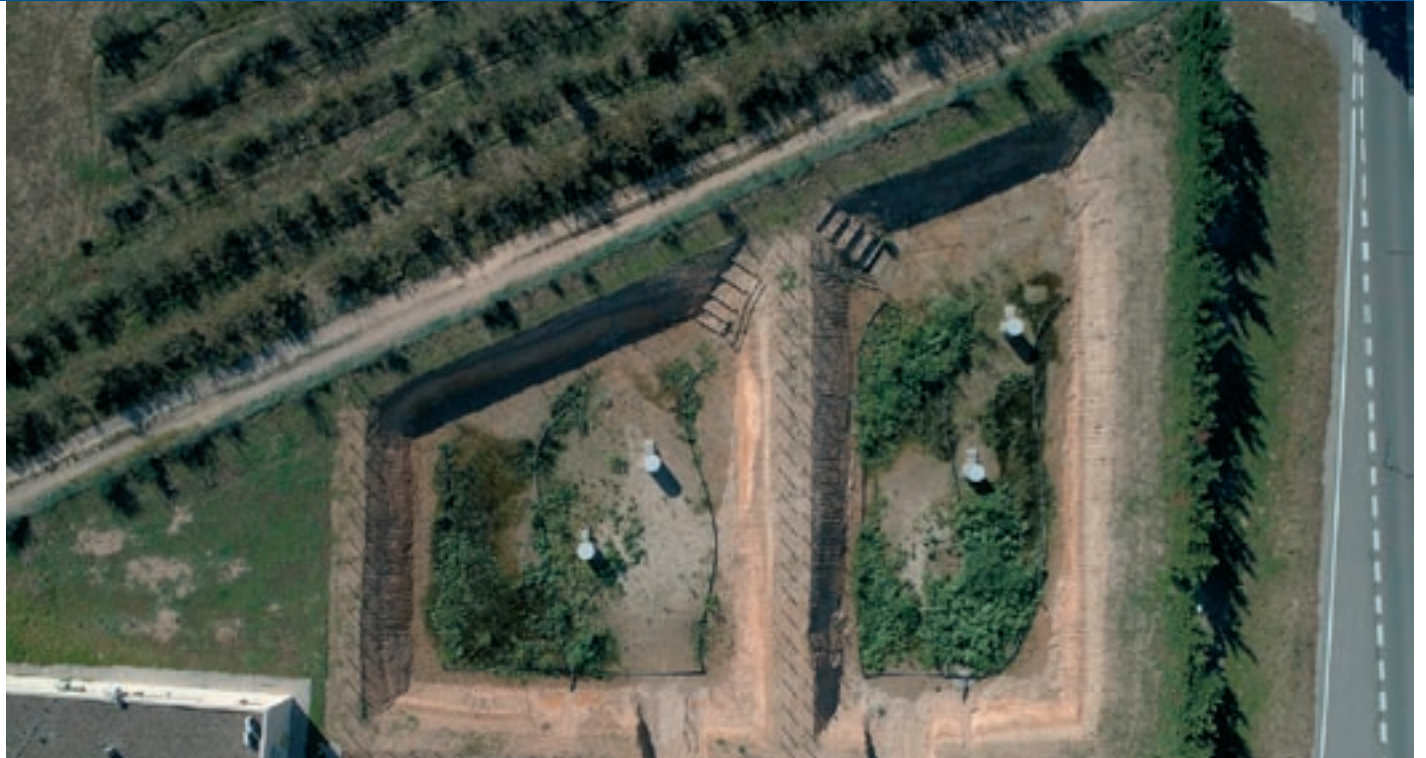
Basses del projecte pilot LIFE REMAR a la depuradora de Cambrils
