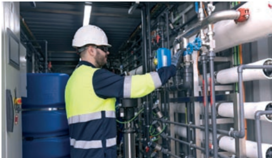
Tècnic a la Plataforma Experimental de Reutilització d'Aigua a la depuradora de Mataró
