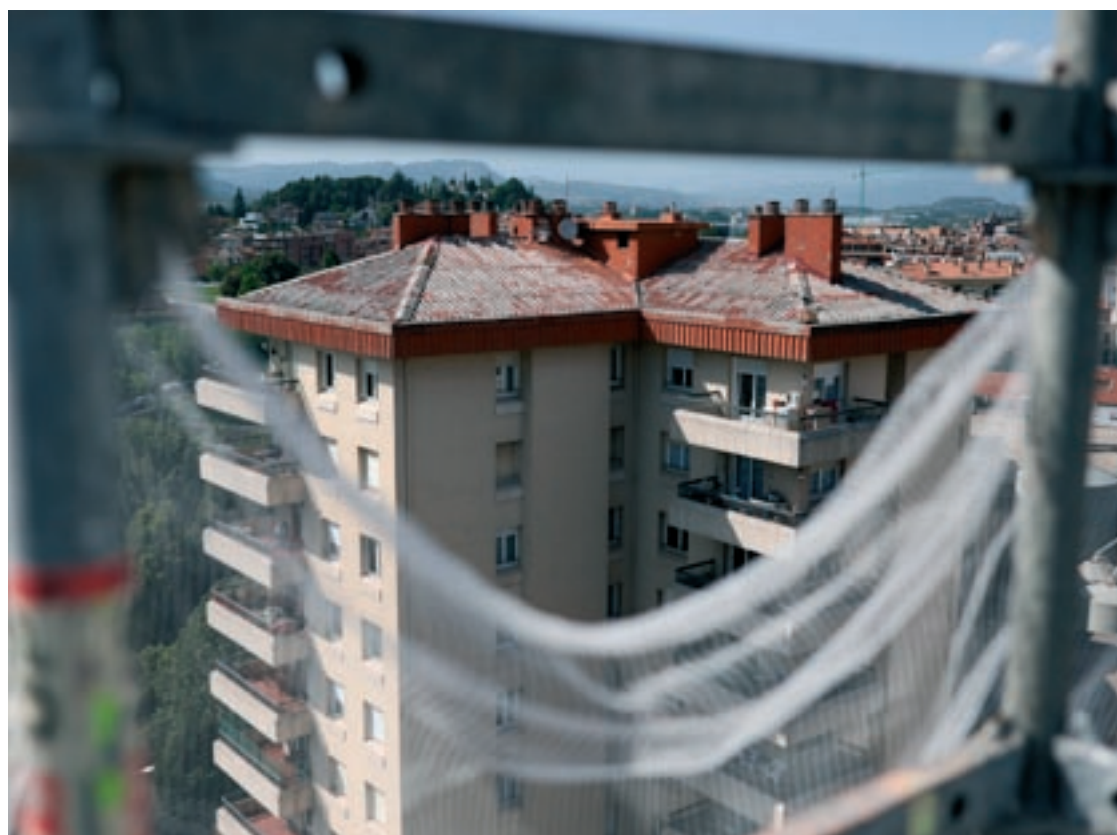
L'origen de les obres va ser, entre d'altres, el mal estat a les teulades, que són de fibrociment
