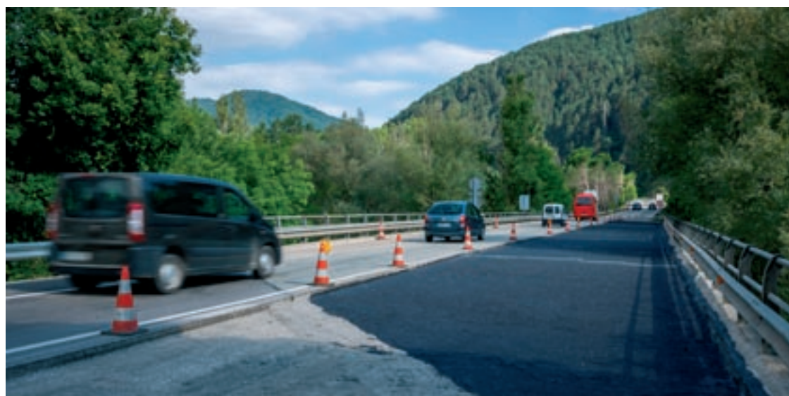
Tram en obres al pont de la variant de la C-17 a Ripoll
