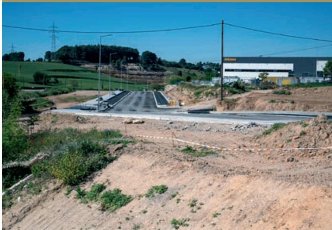
Les obres d'urbanització del sector N on l'Ajuntament té les parcel·les que pretén vendre
