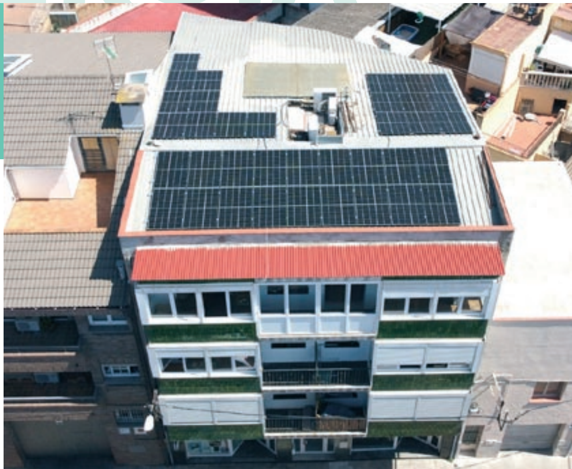
Instal·lació fotovoltaica de la comunitat energètica del carrer Balmes de les Franqueses
