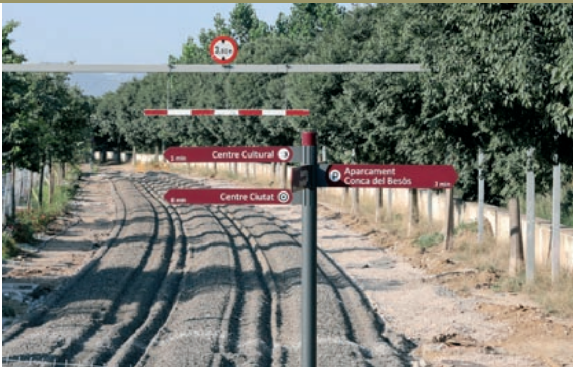
La primera fase de les obres ha consistit en l'arrencament del paviment de formigó del passeig Fluvial
