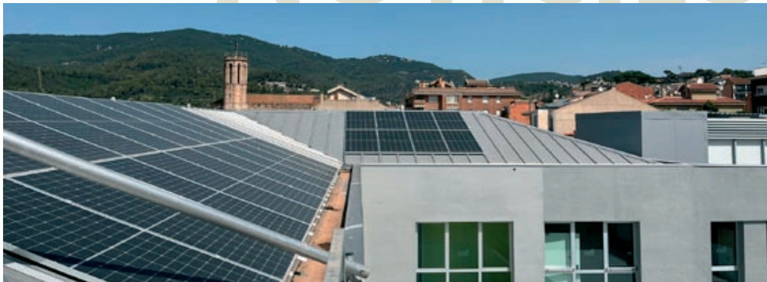
La nova instal·lació fotovoltaica que s'ha fet a la coberta de la Casa dels Mestres de Caldes
