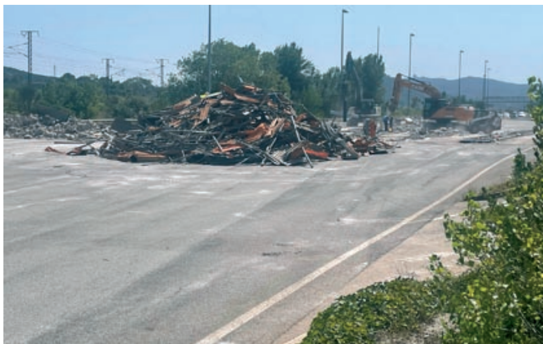
Una excavadora treballant en l'enderroc de part de les instal·lacions que hi havia a la C-33 a la Llagosta
