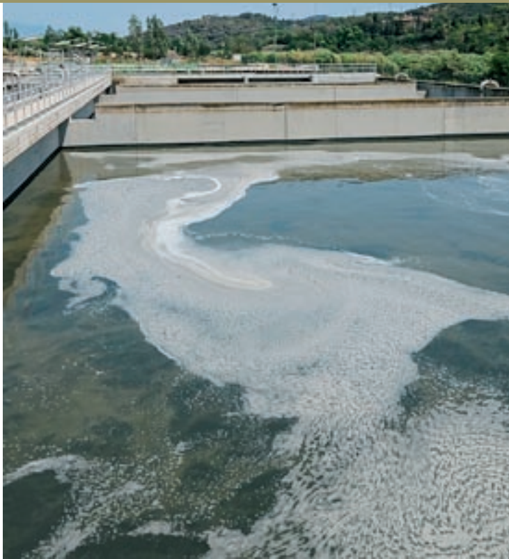
L'EDAR de la Llagosta va retenir 9 milions de litres d'aigua contaminada
