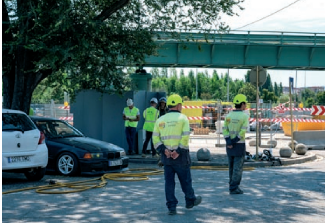
La fuga es va localitzar en una zona del subsol propera a la zona on s'estan fent els fonaments del nou viaducte de l'R3
