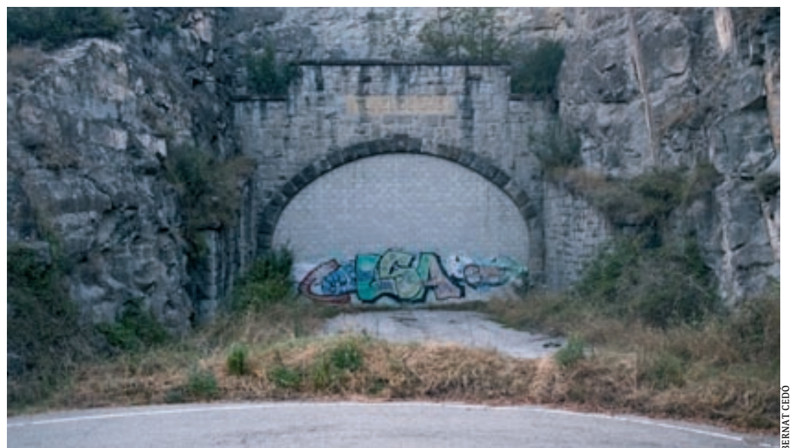
El túnel tapiat a l'antic tram de la carretera N-152, actual C-17, a Orís
