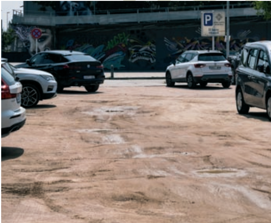
Alguns dels sots de l'aparcament del Sucre després d'una ploguda
