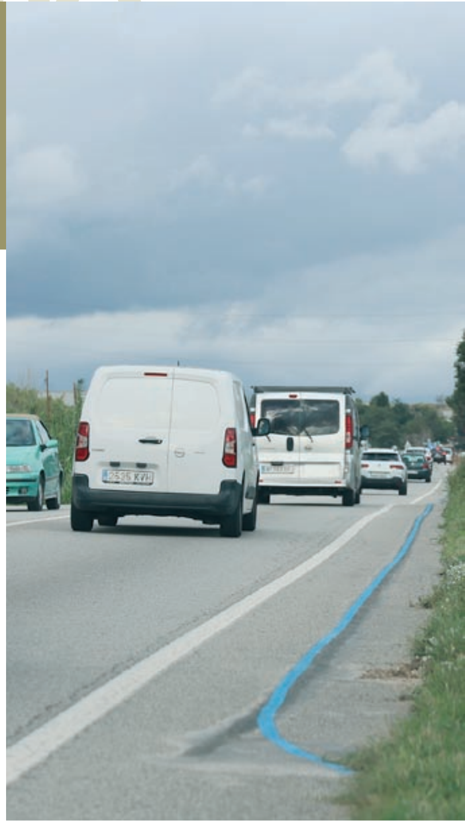
La C-251, al tram de les Franqueses, on s'estan fent les obres d'urbanització del nou sector indu
