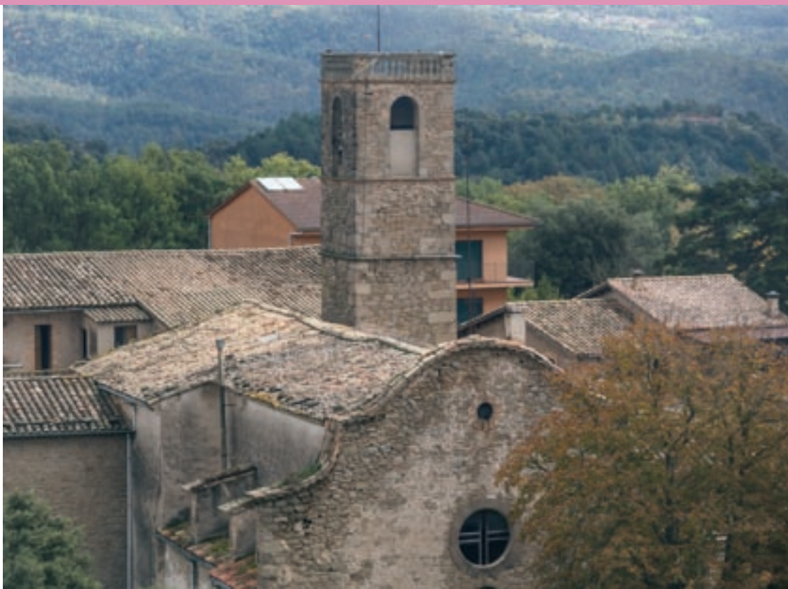
Imatge del campanar i la teulada, l'element que arrossega una patologia estructural greu
