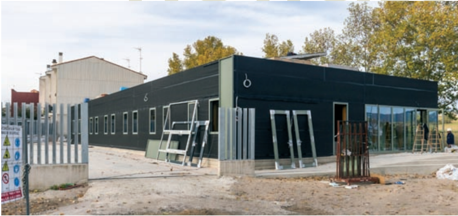
Vista actual de les obres de la nova comissaria de la Policia Local de Manlleu
