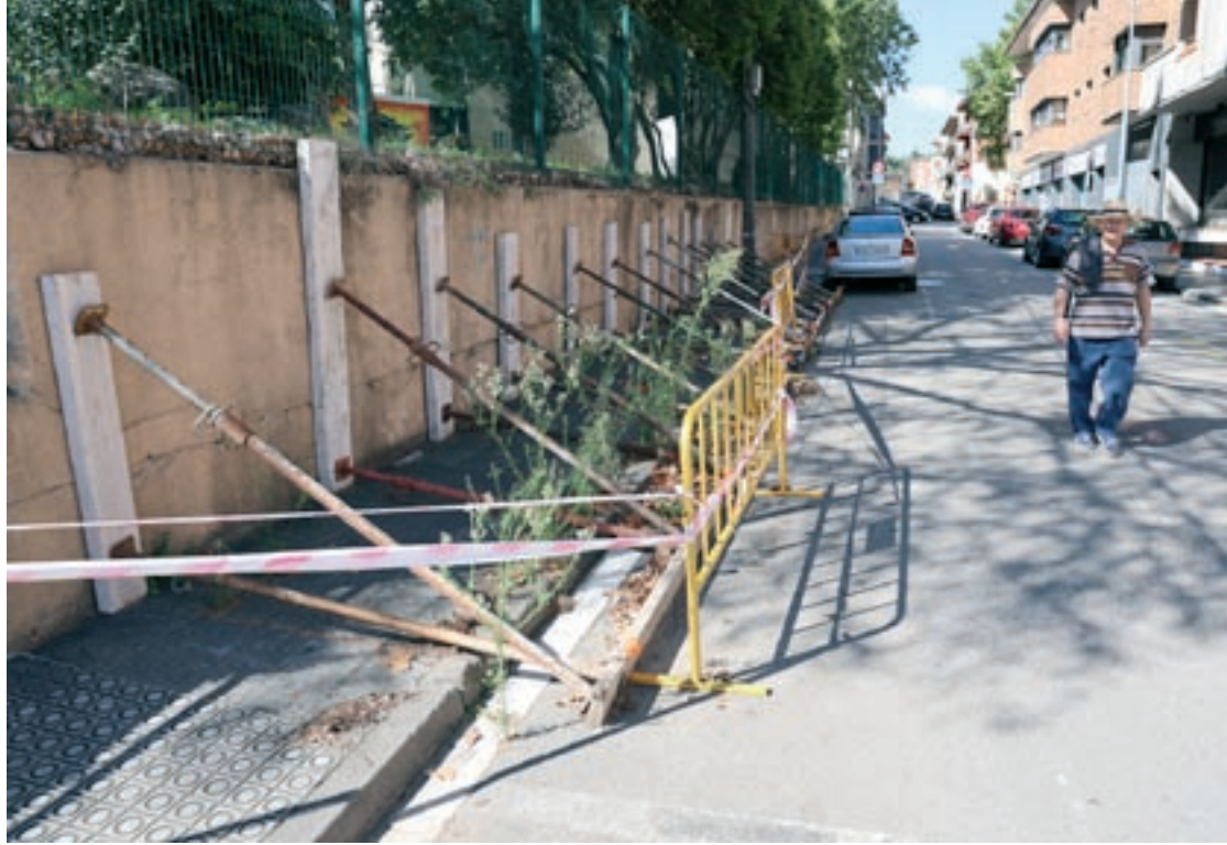
El mur de l'edifici Puigdollers –en una imatge de fa uns mesos– es va haver d'apuntalar i eliminar espais d'aparcament
